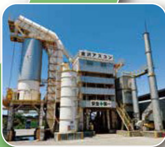
吉田道路(株) 金沢アスコン (60t/h)
